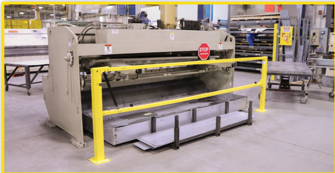
Protection des machines/des équipements
