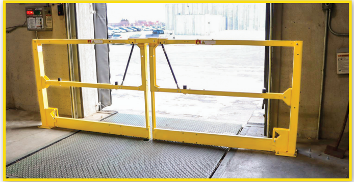
Preparación/protección contra caídas del muelle de carga
